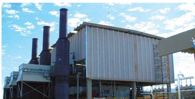
パイプラインステーション
